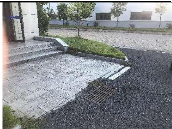
堆场区雨水排水管（雨水口）
