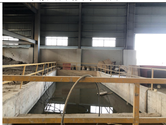
堆场区雨水沉淀池
